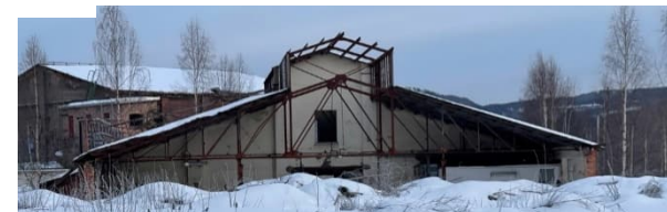
Baksida Elektrolysen Foto 2024
